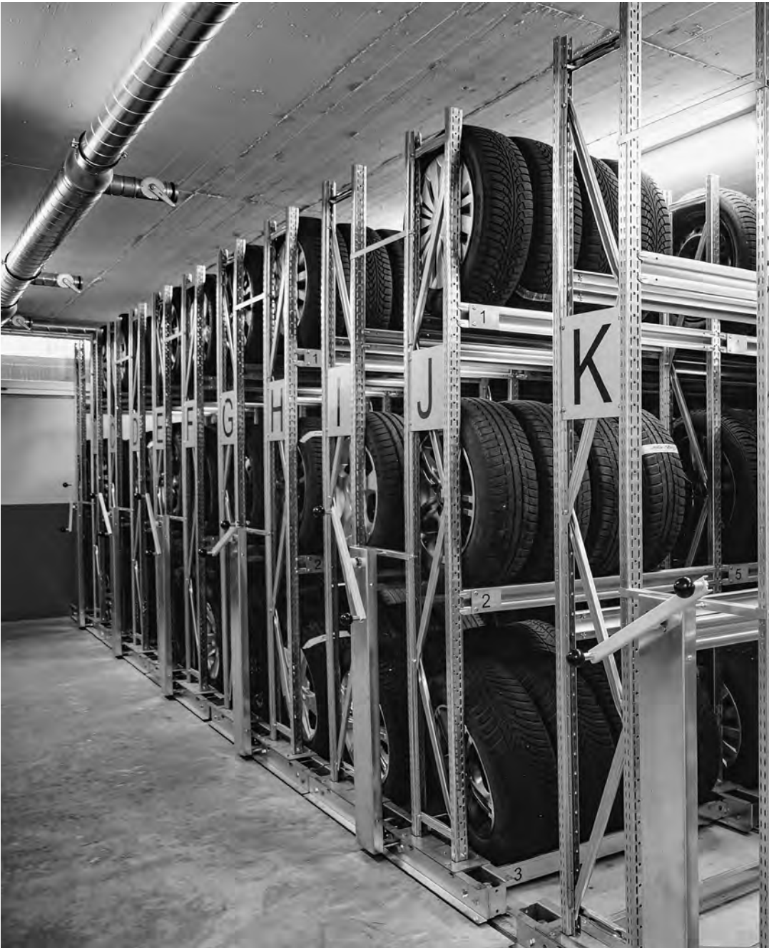
Unter dem neuen Schauraum wurde ein Schiebestell für insgesamt 1500 Pneus und Reifen eingerichtet.
