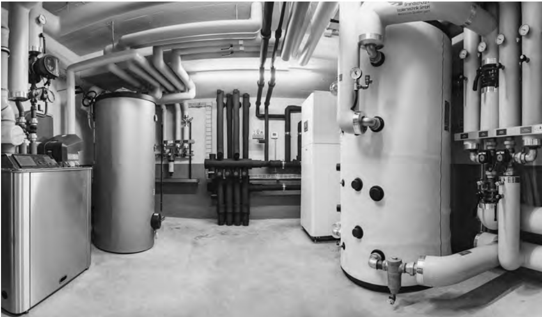
Die Haustechnik befindet sich in einem Raum unter dem 1945 erbauten Stammhaus. (Bilder: Hans Ulrich Gantenbein)
